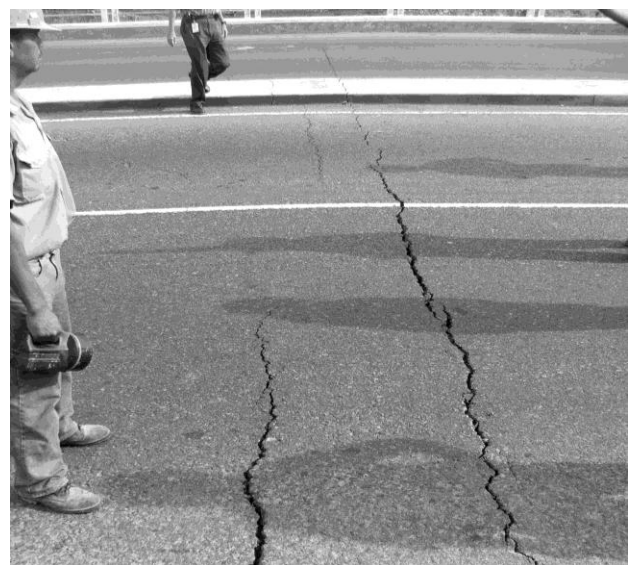
Figura 19. Agrietamiento del tablero debido al evento del 5 de Enero de 2006, en correspondencia con la misma sección de ruptura del arco mostrada en la Figura 18. (Enero 5, 2006).
