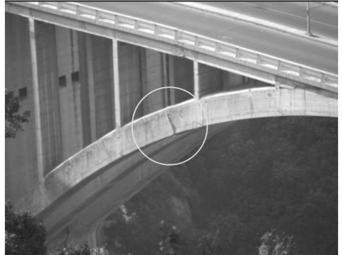
Figura 18. Vista panorámica de la ruptura del arco Este, destacada con un círculo. (Enero 5, 2006).
