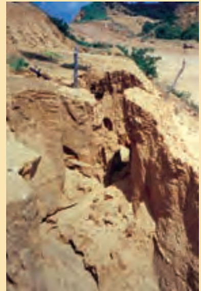
Figura 20 Carcava de erosión en areniscas finas pobremente cementadas
