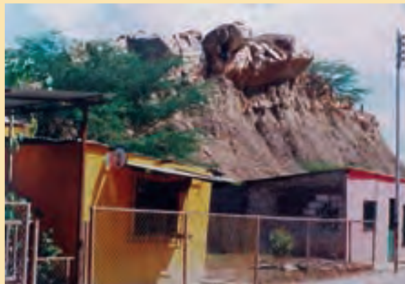
Falla de volcamiento de capas de areniscas por meteorización de la capa de lutita subyacente.
