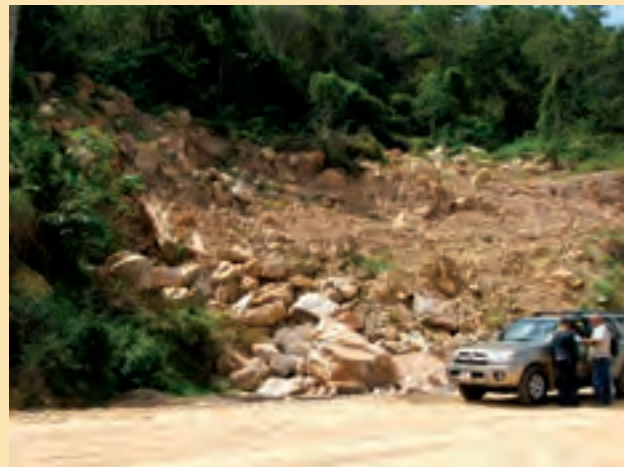
b) Deslizamiento de talud de corte en suelo coluvial.
