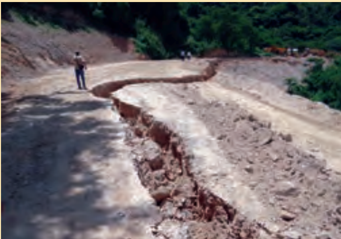
Figura 42 Relleno en ladera, en proceso de deslizamiento
