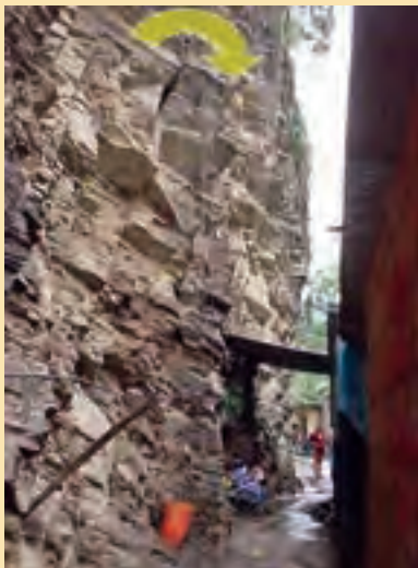
Inicio de una falla por volcamiento detrás de una vivienda.
