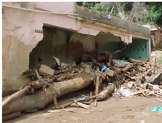
Fig. 14. Daño causado por un tronco de árbol en una vivienda de la quebrada Catuche, Caracas.
