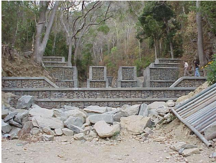
Fig. 24 Presa abierta de gaviones revestidos con concreto. Presa Las Comadres, afluente de la Quebrada Piedra Azul.
